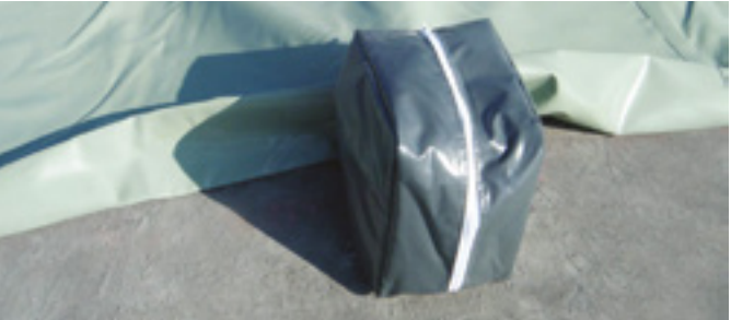
Protection thermique de vanne
