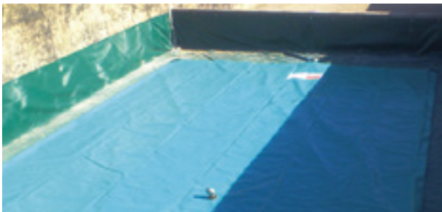
Bassin de rétention sur murets
