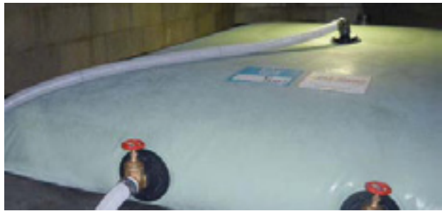
Stockage eau de pluie 10 m³ en vide sanitaire
